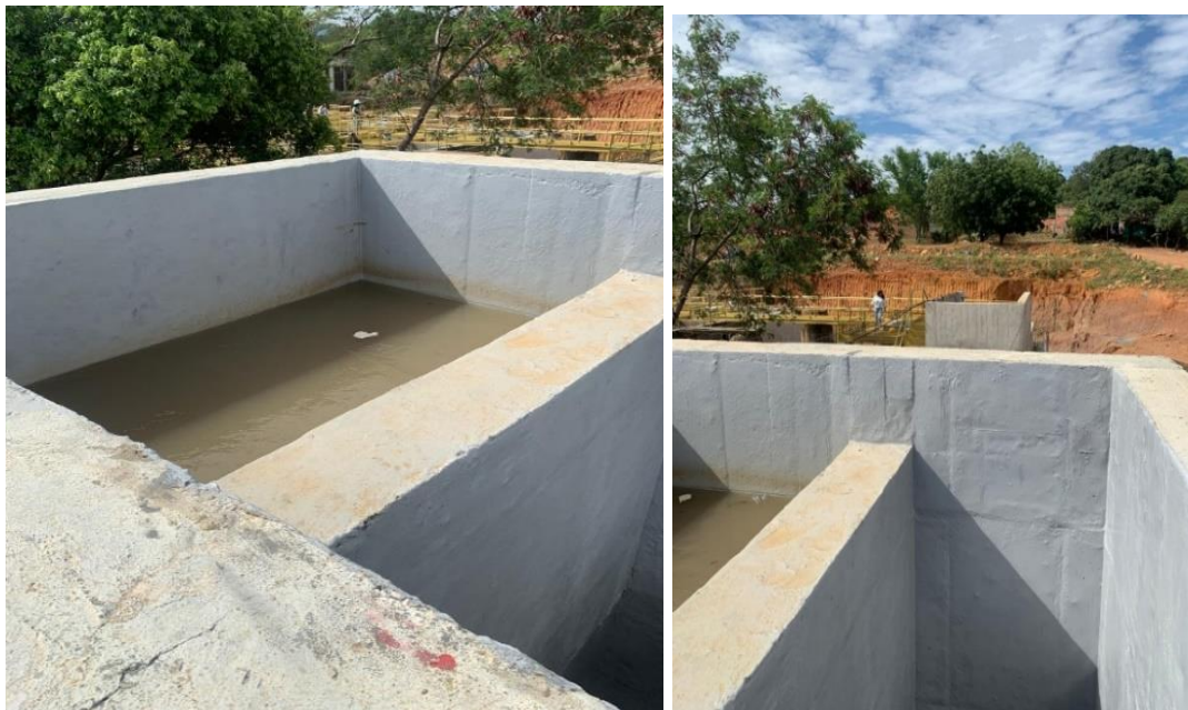
Fotografía No.20 y 21. Cámara de llegada, con la aducción nueva. Fotografías tomadas el 27 de septiembre
