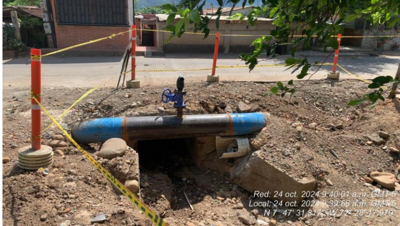
Fotografía No.7. Estado actual paso No. 4 Fotografías tomadas el Jueves, 24 de octubre
