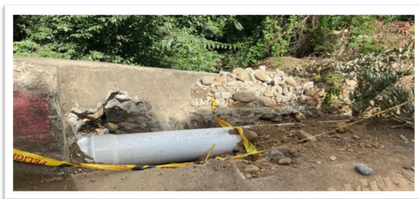
Afectación a la estructura de concreto de la obra hidráulica existente
