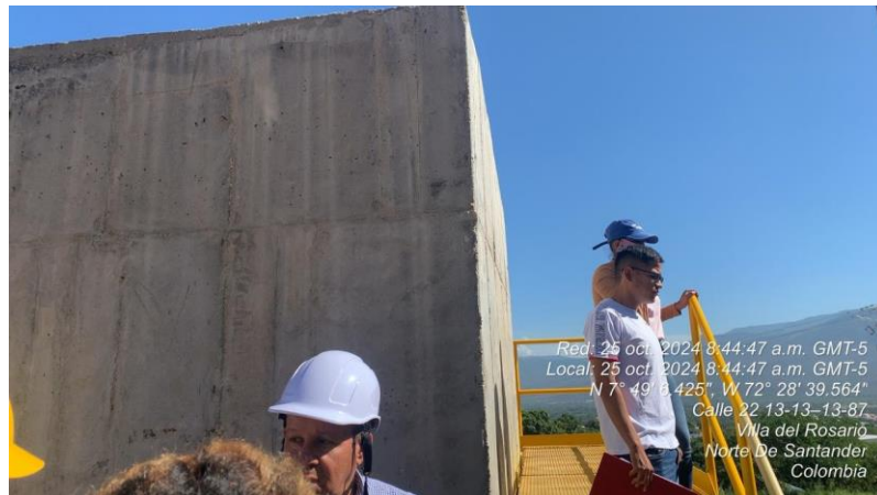
Fotografía No.1. Cámara de llegada, con la aducción nueva. Fotografías tomadas el 25 de octubre
