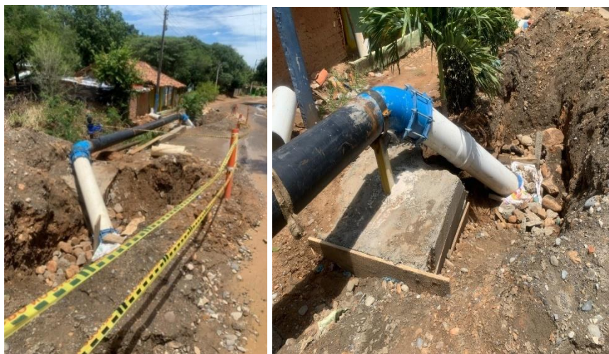
Fotografía No. 5. Estado actual paso No. 2. /Fotografía No. 6. Anclaje soporte paso especial No. 2 Fotografías tomadas el viernes, 27 de septiembre
