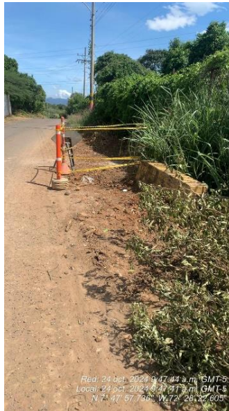
Fotografía No.12. Estado actual paso especial No. 7 Fotografías tomadas el Jueves, 24 de octubre
