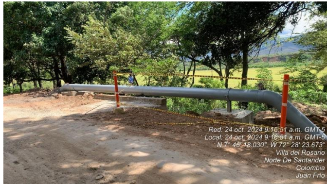
Fotografía No. 3. Estado actual paso especial No. 1.
