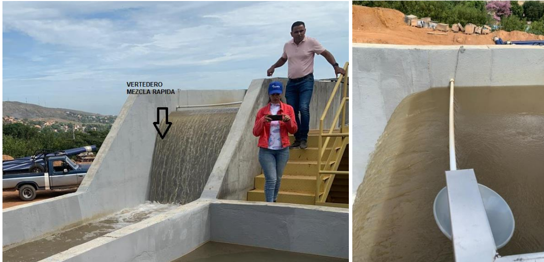
Fotografía No.26 y 27 Vertedero mezcla rápida y flauta para aplicación de coagulante. Fotografías tomadas el 27 de septiembre
