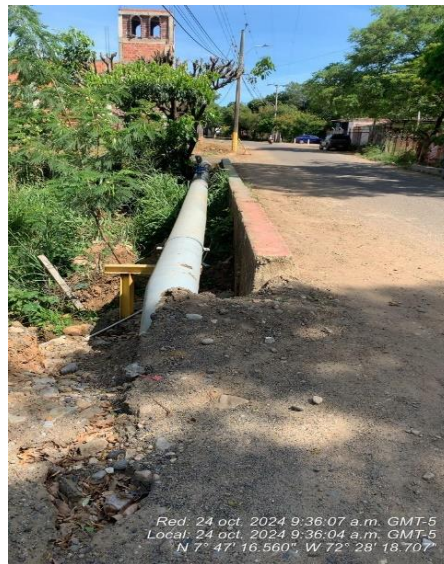
Fotografía No. 6. Estado actual del paso especial No. 3 Fotografías tomadas el Jueves, 24 de octubre
