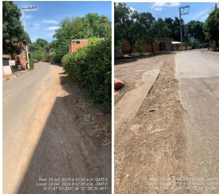
Fotografía No. 8 y 9 Paso especial No. 5. Terminado falta recuperación del pavimento Fotografías tomadas el Jueves, 24 octubre
