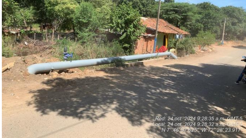
Fotografía No. 5. Estado actual paso No. 2 Fotografías tomadas el Jueves, 24 de octubre
