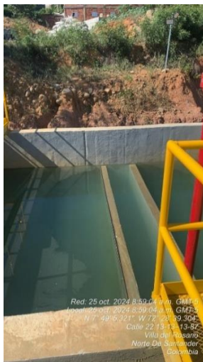
Fotografía No.7 filtros nuevos. Fotografías tomadas el 25 de octubre
