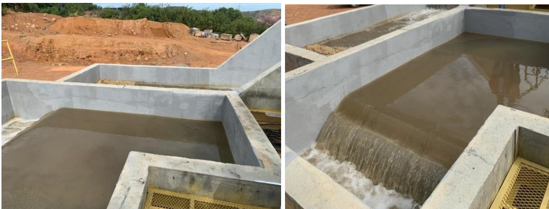
Fotografía No.28 y 29 Cámara de distribución de caudales, y vertedero para cámara de entrada a tren de tratamiento nuevo. Fotografías tomadas el 27 de septiembre
