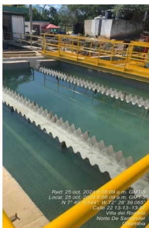
Fotografía No.6 sedimentador nuevo, Fotografías tomadas el 25 de octubre
