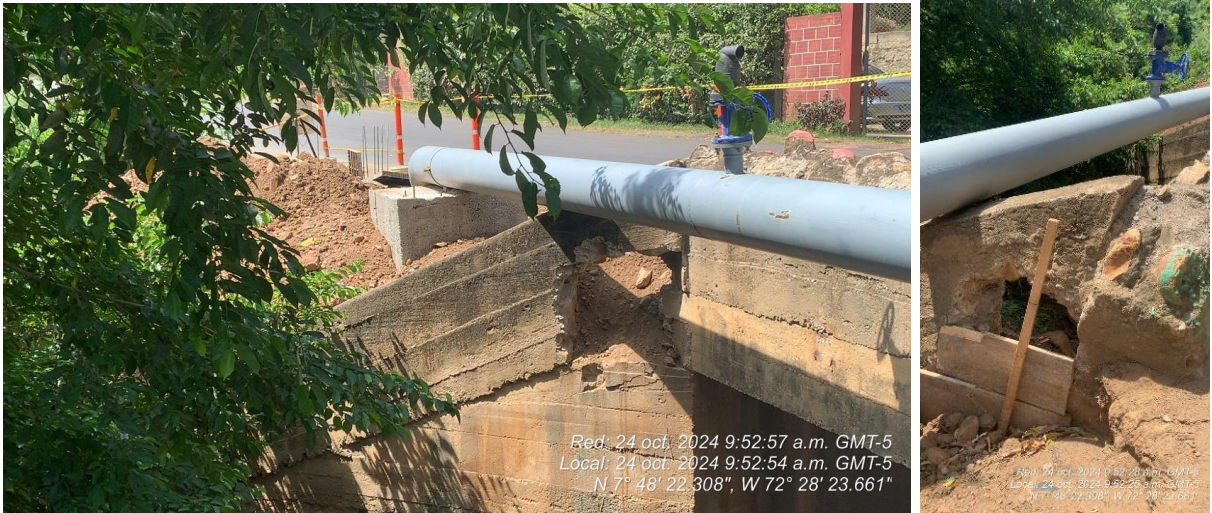
Fotografía No. 15 y 16. Paso especial No. 9, aletas del box-culvert sin reparar Fotografías tomadas el Jueves, 24 de Octubre de 2024
