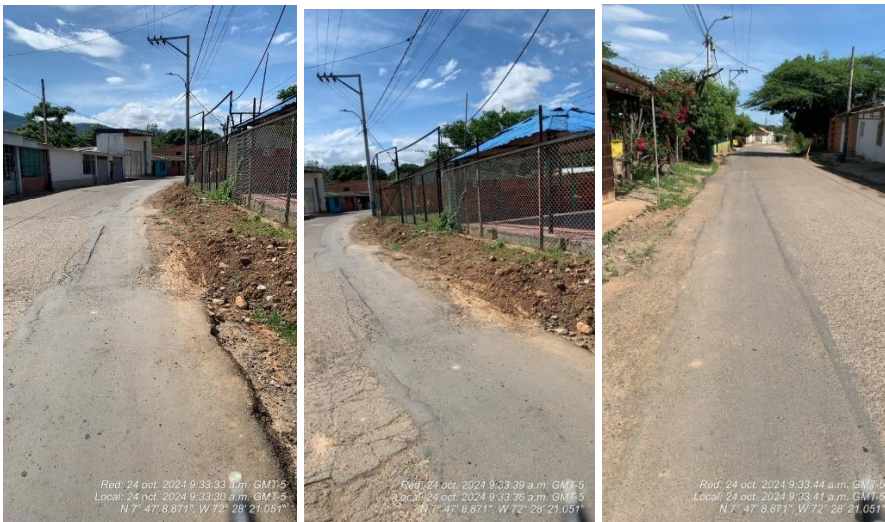
Fotografía No. 21,22 y 23. Tramos sin recuperar pavimento Fotografías tomadas el Jueves, 24 de Octubre de 2024
