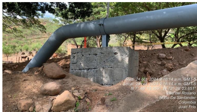
Fotografía No. 4. Soporte y tubería en AC. Fotografías tomadas el Jueves, 24 de octubre
