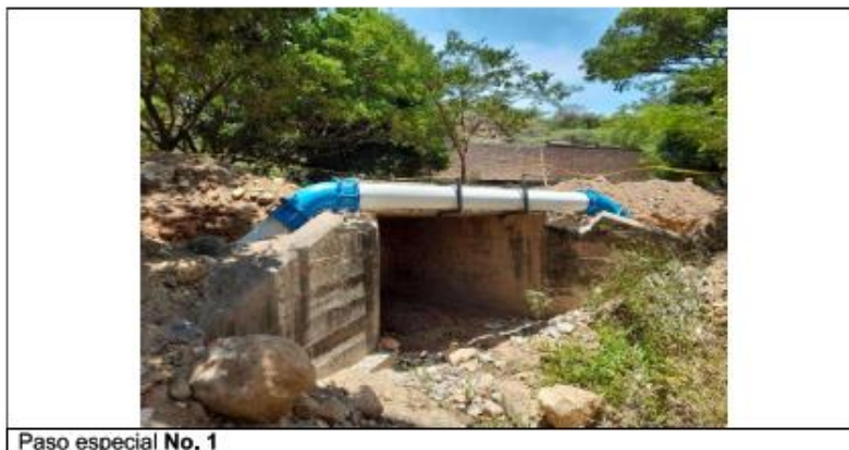
Construcción de pasos elevados con acero al carbono – Tomado del Informe de Aqualia Villa del Rosario SAS
