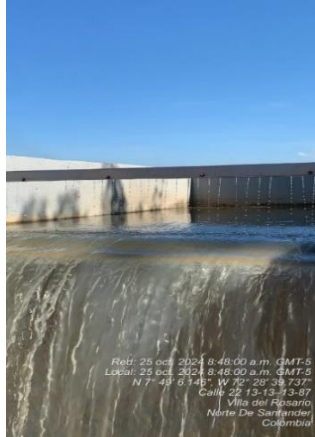
Fotografía No.3 Vertedero mezcla rápida y flauta para aplicación de coagulante, terminada. Fotografías tomadas el 25 de octubre
