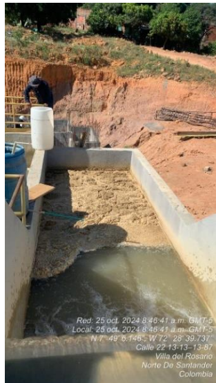
Fotografía No. 4 Cámara de distribución de caudales, y vertedero para cámara de entrada a tren de tratamiento nuevo. Fotografías tomadas el 25 de octubre
