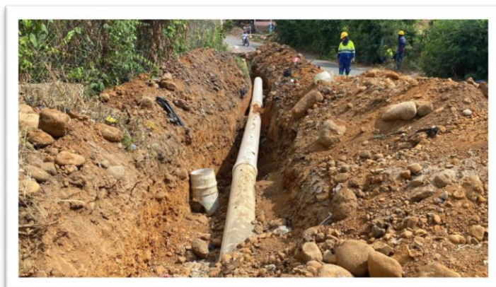
Deficiencia en la alineación horizontal de la tubería
