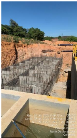
Fotografía No.8 Cámara de contacto de cloro. Fotografías tomadas el 25 de octubre
