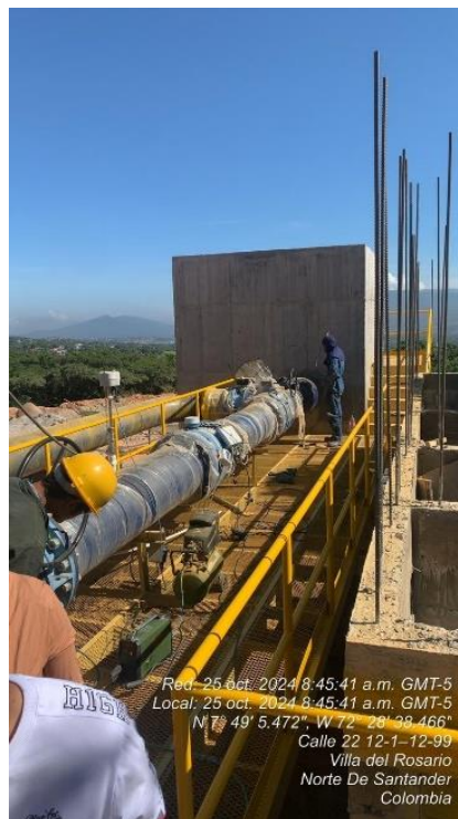
Fotografía No.2. Micromedidor instalado, Fotografías tomadas el 25 de octubre
