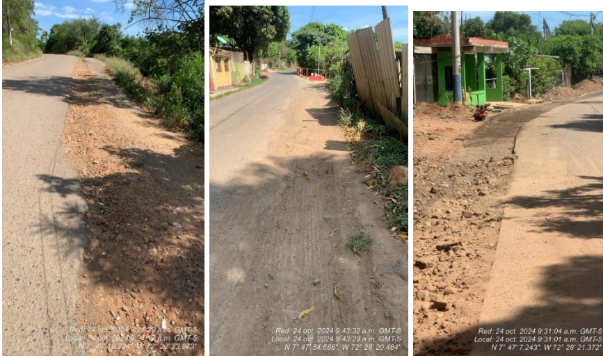
Fotografía No. 18,19 y 20. Tramos sin recuperar pavimento Fotografías tomadas el Jueves, 24 de Octubre de 2024
