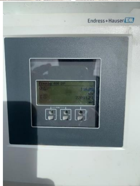
Fotografía No.22 ,23 y 24. Macromedidor instalado, indica un caudal de 116,89 lps, línea nueva, Fotografías tomadas el 27 de septiembre
