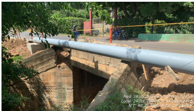
Fotografía No. 14. Estado actual paso especial No. 9 Fotografías tomadas el Jueves, 24 de Octubre de 2024
