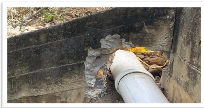
Afectación a la estructura de concreto de la obra hidráulica existente
