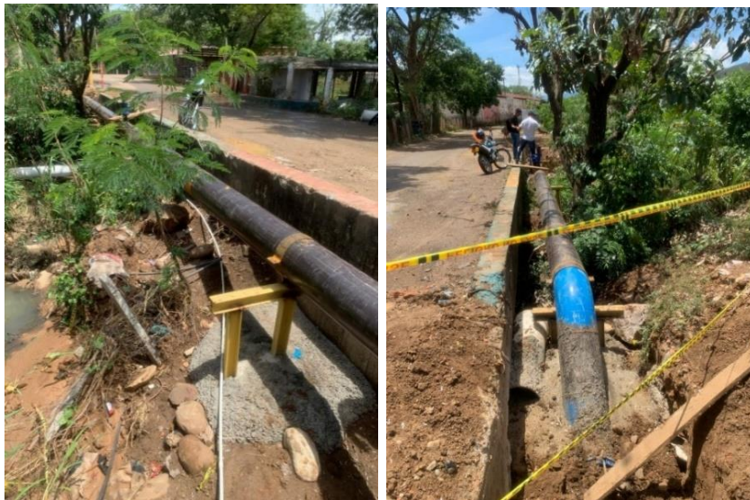
Fotografía No. 7. Soportes de paso especial No. 3 / Fotografía No. 8. Tubería AC paso No. 3
