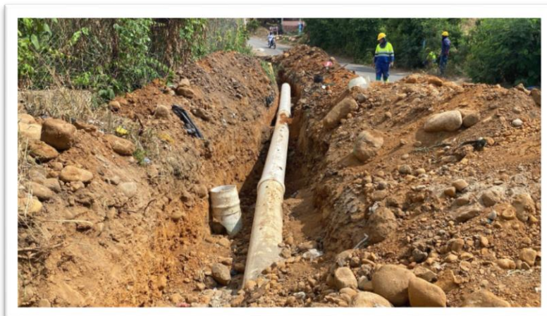
Utilización de material granular con sobre tamaños en los rellenos
